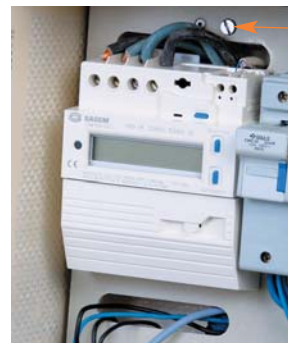
Sécurisation du comptage par plombage simultané compteur/platine
